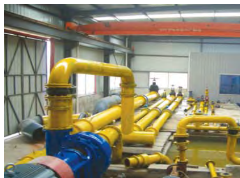
▲ 喷嘴测试泵站
